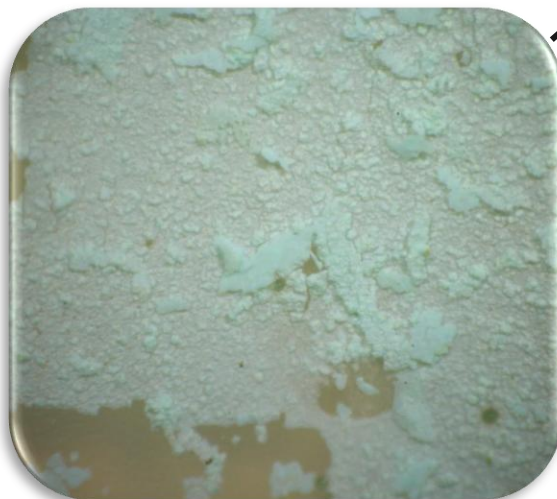
Figur 8: Foto taget av Micans på insidan av rören där en grön beläggning syns.
