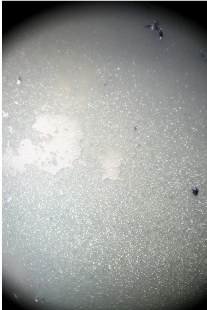
Figur 5: Insidan av röret från åtgärdssidan, där biofilm syns.
